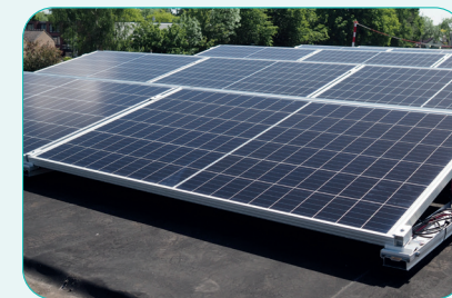
Voorbeeld van zonnepanelen op een dak
